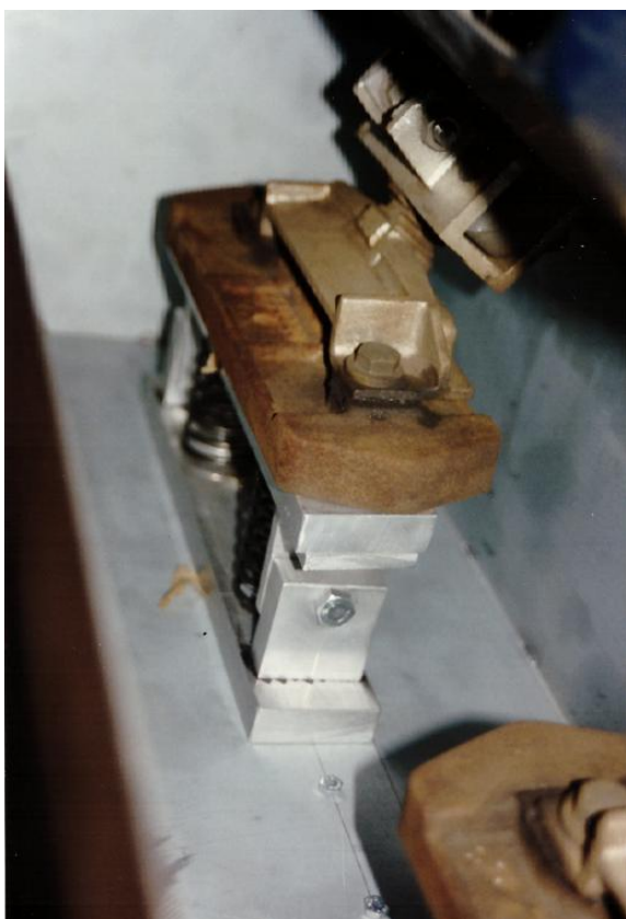
Figure 30 (ci-dessus) – Supports situés à l'intérieur du chariot sur lesquels viennent en contact les frotteurs.
