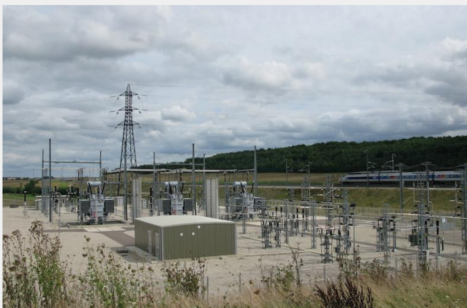
Figure 6 : Sous-station Trois Domaines vue d'ensemble. Au premier plan le bâtiment contrôle commande, à l'arrière l'arrivée HT et les trois transformateurs de 60 MVA. Photo : Alain JEUNESSE
